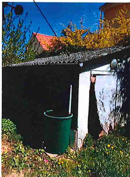
Panneaux de couverture en fibres ciment (contient de l'amiante)
