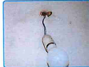
Anomalie B.8.3 e sur Install. n°1
