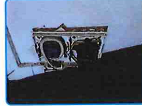
Anomalie B.8.3 e sur Install. n°1
