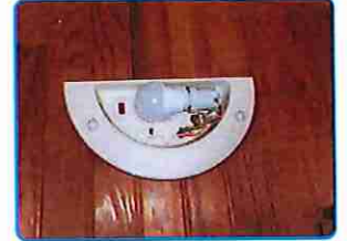
Anomalie B.8.3 e sur Install. n°1
