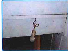
Anomalie B.8.3 e sur Install. n°1
